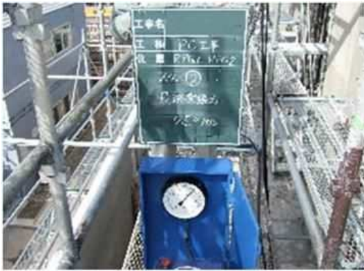
油圧計の確認
